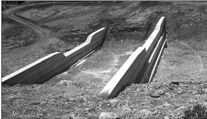
Φωτογραφία 8. Φράγματα ανάσχεσης (προσωρινής συγκράτησης) πλημμυρικής απορροής μετά από πυροκαγιά στα όρια της ορεινής και πεδινής λεκάνης (περιοχή Στυλίδας).
